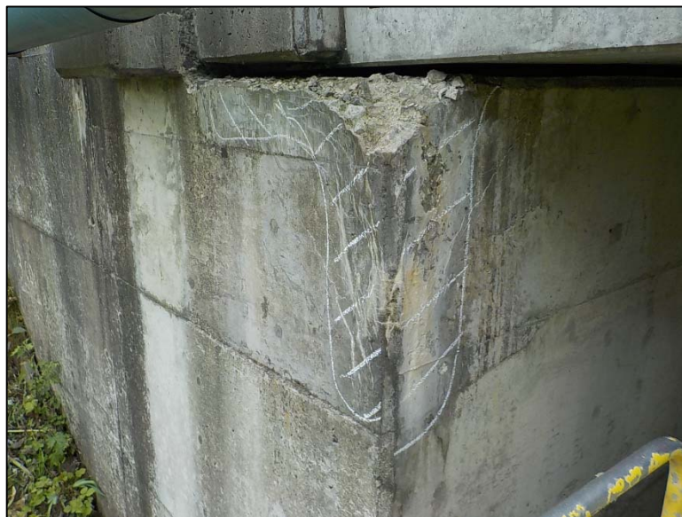
写真3-1 凍害による損傷状況(博亀橋・橋台)
